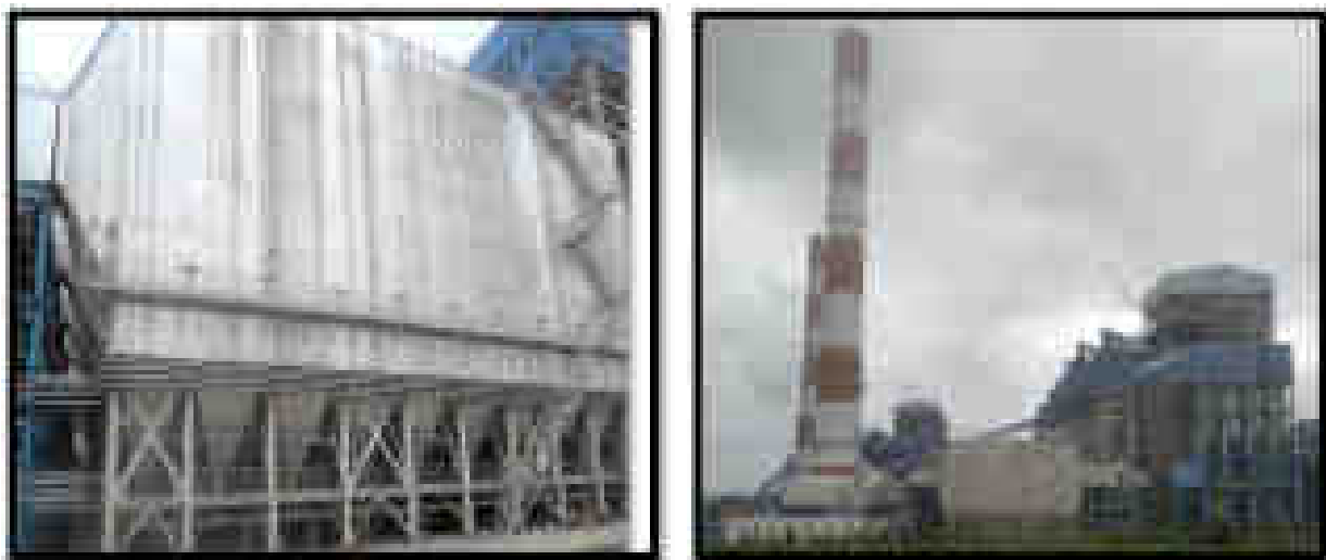
Fig. 11 Electro Static Precipitator installed at TTPP
