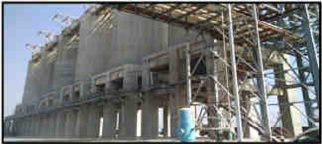
Fig. 13 Fly ash Silos (1700 MTx6 Nos.) at TTPP
