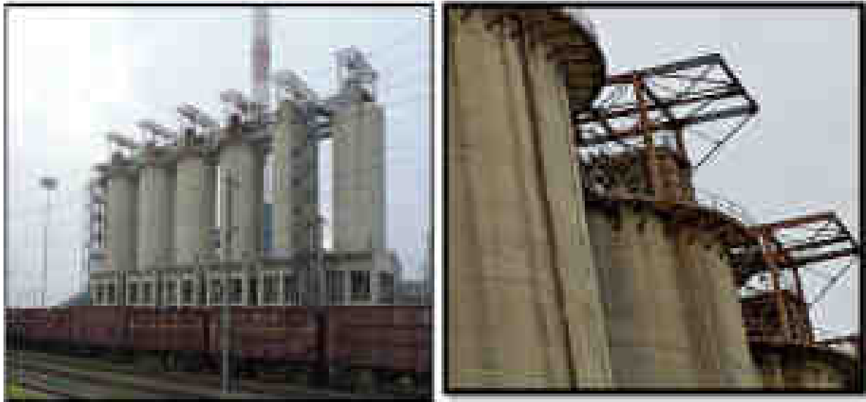
Fig.12 Fly Ash Silo installed at TTPP
